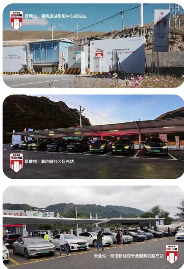
图 3.1-2 华为全液冷超充站
